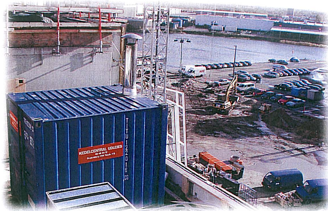
450 kW gasforsyнет varmecentral på 4. sal hos Philips
