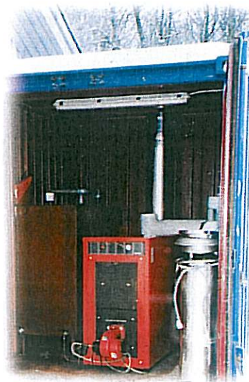
230 kW olieforsyнет varmecentral
