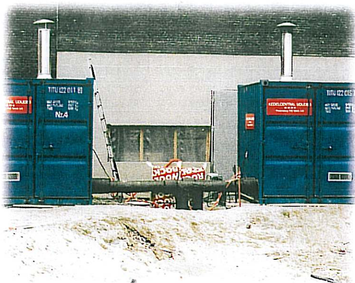
2 stk. 450 kW sammenkoblede gasforsynede varmecentraler
